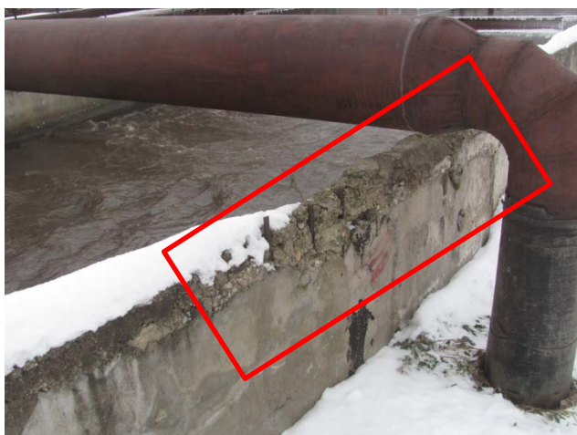
Рисунок 1.2.1 – Разрушение бетонных ограждающих конструкций аэротенка линии № 4
