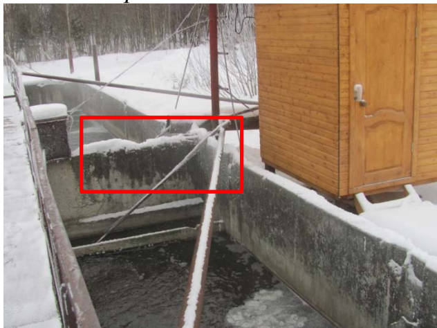
Рисунок 1.2.3 – Разрушение бетонных ограждающих конструкций контактного резервуара № 2
