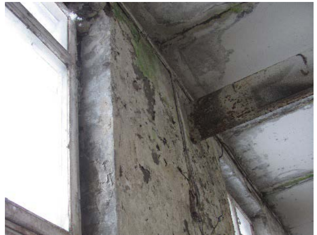
Рисунок 1.4.3.2 – Увлажнение, поражение биодеструкторами, разрушение штукатурного слоя кирпичной кладки стен здания станции второго подъема
