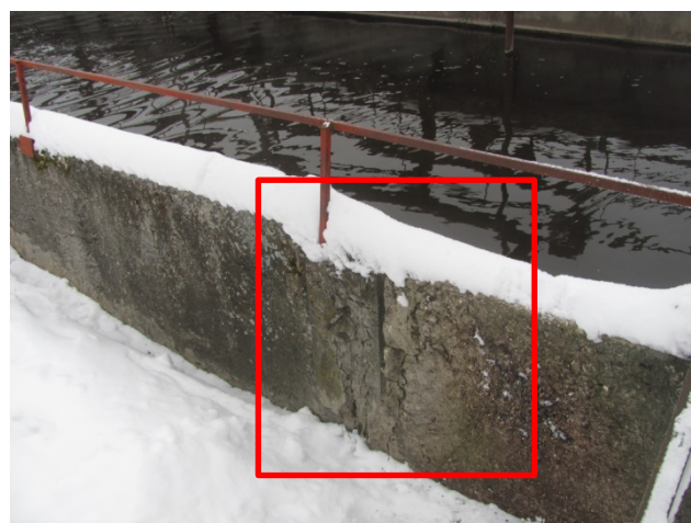
Рисунок 1.2.2 – Разрушение бетонных ограждающих конструкций вторичного отстойника линии № 4
