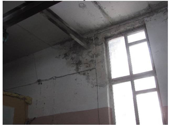
Рисунок 1.4.3.4 – Увлажнение, поражение биодеструкторами, разрушение штукатурного слоя кирпичной кладки стены здания станции второго подъема
