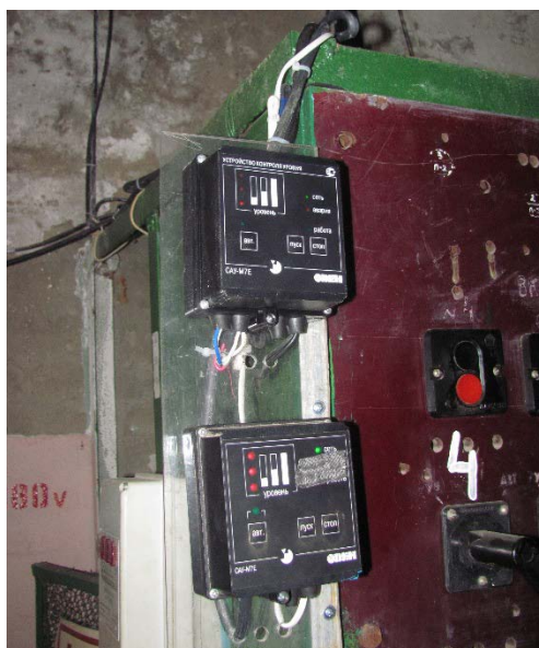
Рисунок 4.4.1 – Устройства контроля уровня воды в резервуарах
