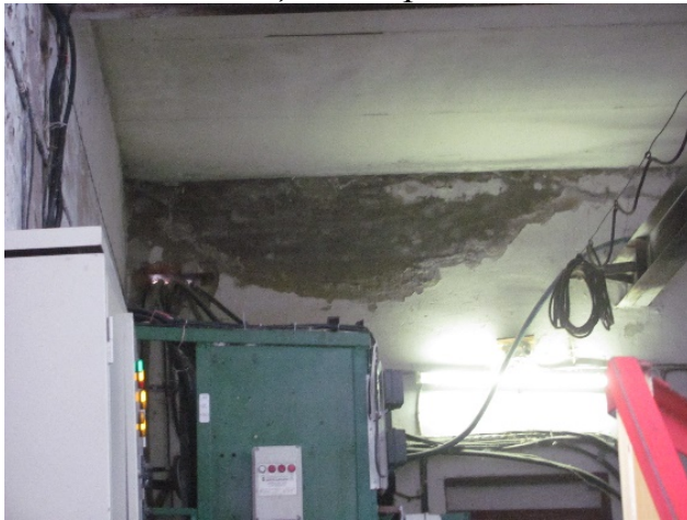
Рисунок 1.4.3.3 – Увлажнение, поражение биодеструкторами, разрушение штукатурного слоя кирпичной кладки стены здания станции второго подъема
